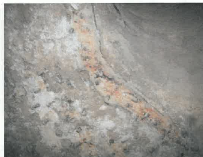
二次燃烧室(上部)
